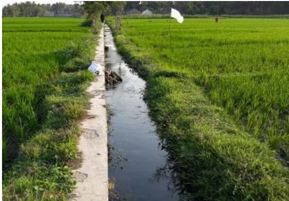
Gambar 1 Kondisi saluran irigasi DI Ewon 485
